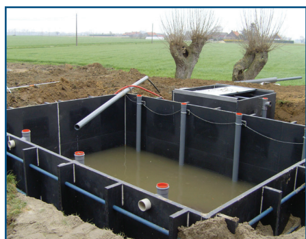
ČIŠTĚNÍ ODPADNÍCH VOD
